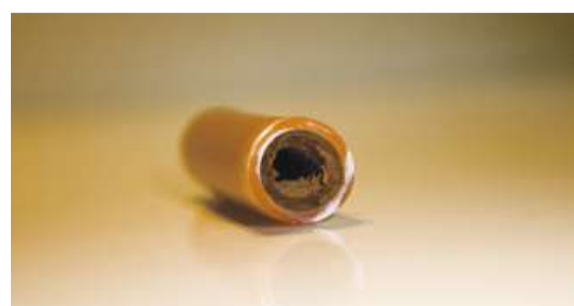
Versprödetes und verschlammtes Bodenheizungsrohr.
